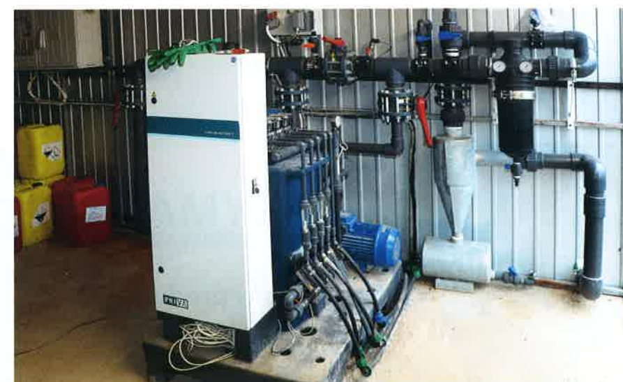
Fot. 6. Sterownik na palecie transportowej, podłączony do instalacji
